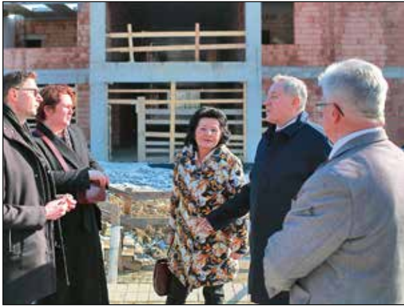
Wizytacja budowy nowego budynku Zespołu Szkół Centrum Kształcenia Rolniczego w Nowym Targu, dofinansowanego kwotą 62 mln zł przez Ministra Rolnictwa i RW, 2023-03-01
